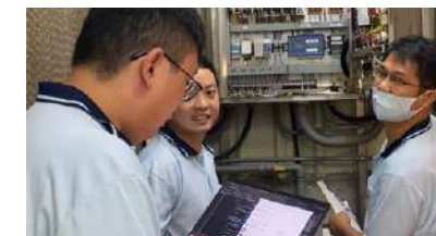
資訊部門改造各豬場的電盤，使其聯網，讓 Vital 得以發號施令，遠端控制豬場設備。
