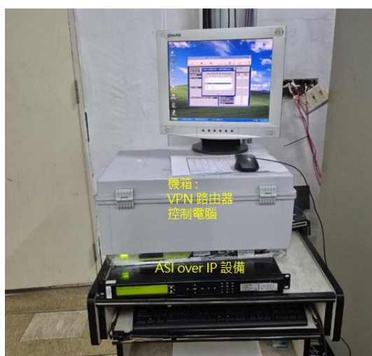
圖 5- 15、竹子山 ASI over IP 設備
