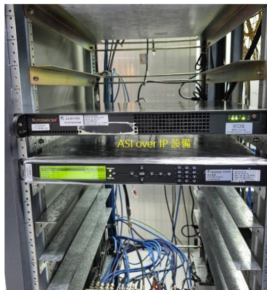
圖 5-13、台視主控室 ASI over IP 設備
