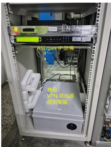
圖 5- 14、枕頭山 ASI over IP 設備
