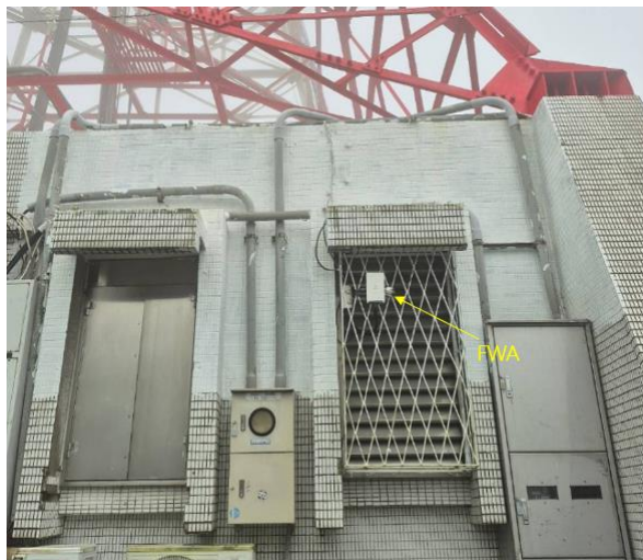
圖 5-11、枕頭山 FWA 終端架設
